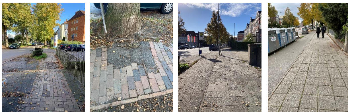
Abbildung 72: Zustand der Fußwege (Quelle: ZEBAU)
