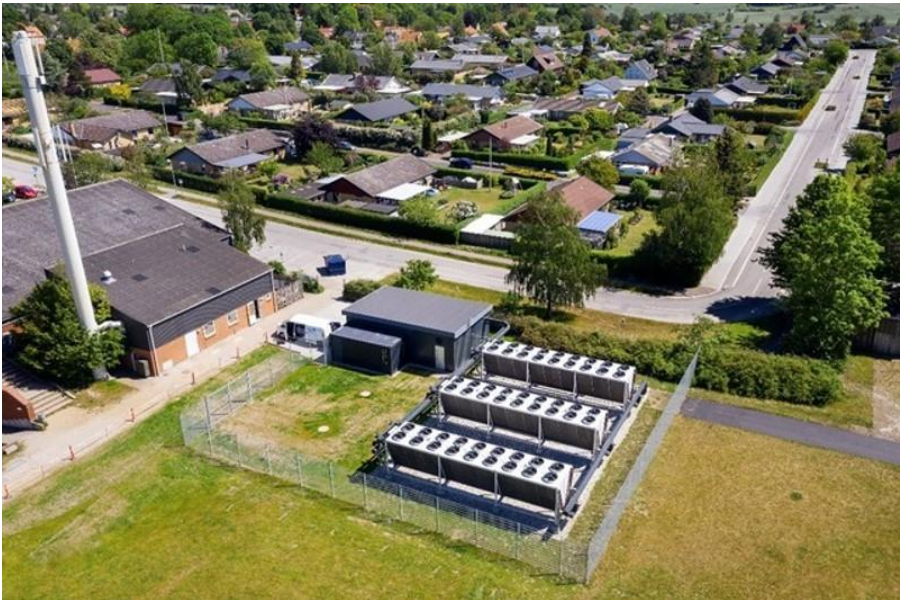
Abbildung 14: 1-MW Luftwärmepumpe in Slagslund Dänemark (Urheber PlanEnergi)
