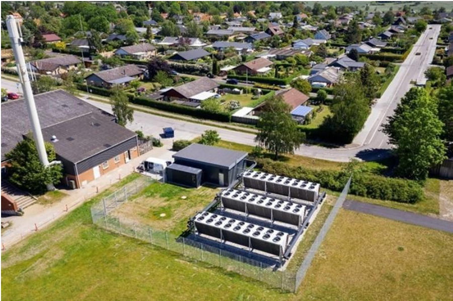
Abbildung 43: 1-MW Luftwärmepumpe in Slagslund Dänemark (Urheber PlanEnergi)
