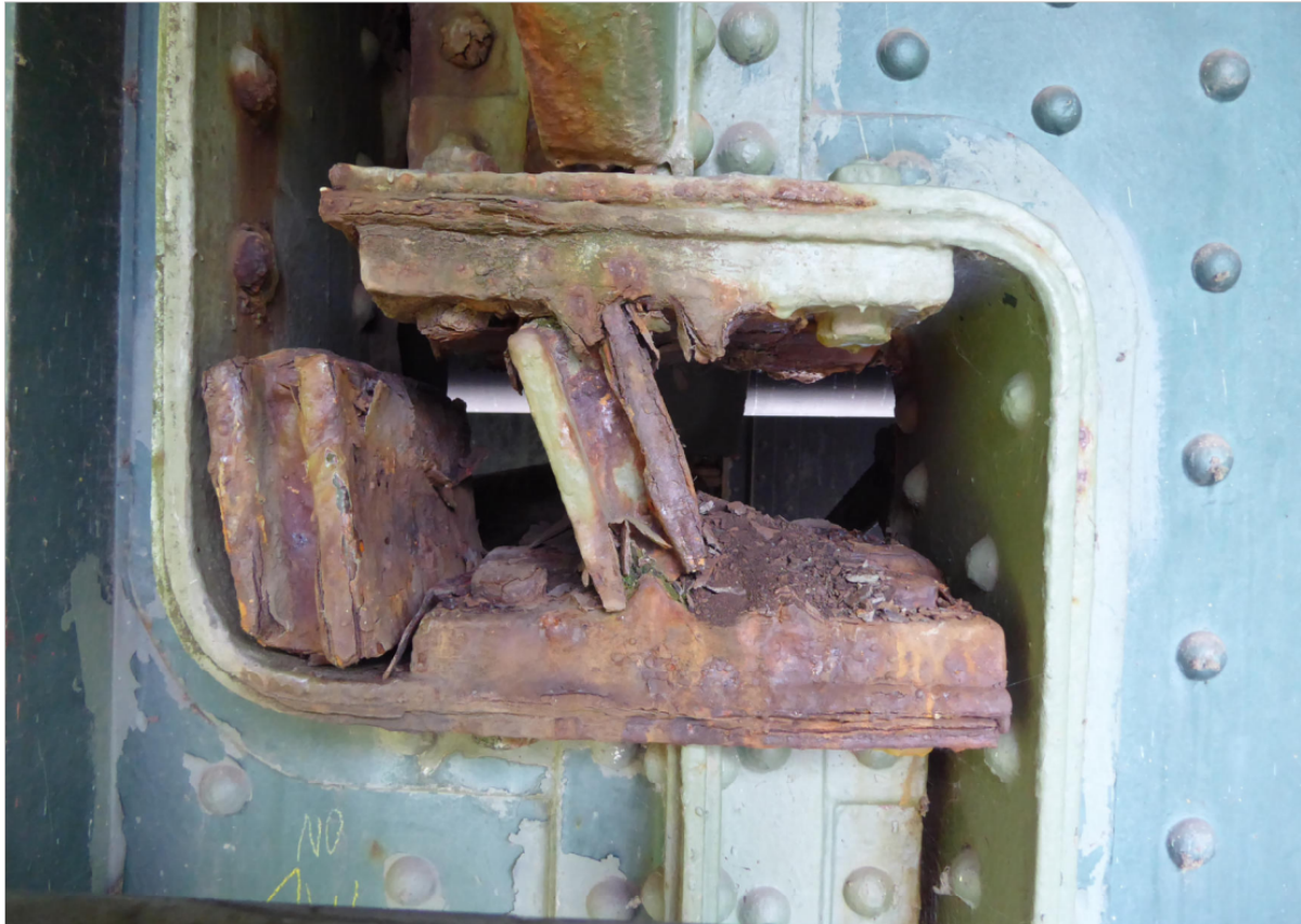
Abb. 4: Schädigung am Stelzenlager (Quelle: HL, 5.660)
