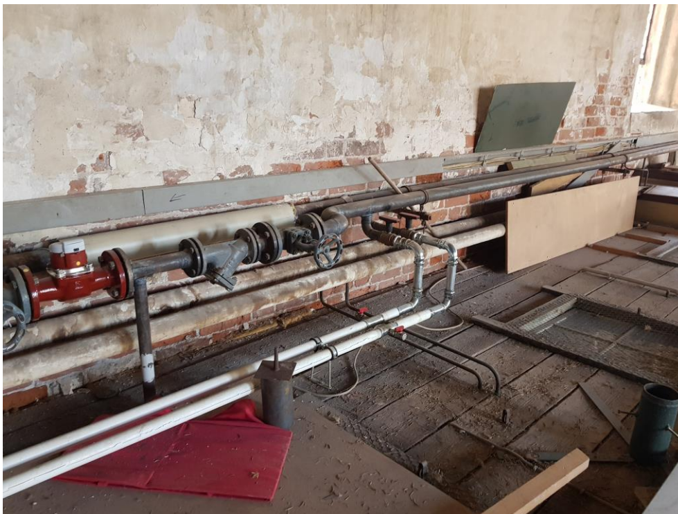
Heizung / Sanitär: Historische Versorgungsleitungen oberhalb der Kabäuschen
