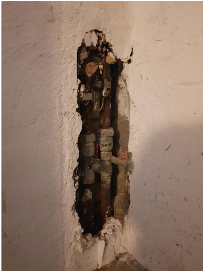
Heizung / Sanitär: Historische Bestandsleitungen (Trinkwasser und Heizung)
