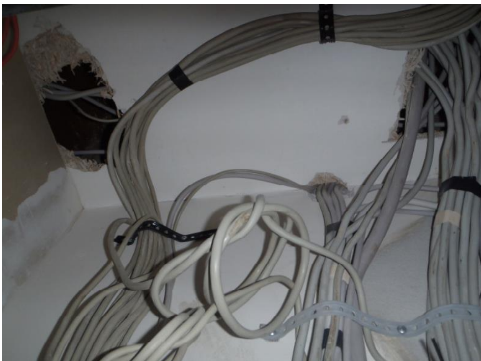
Elektrotechnik: Leitungsführungen / Brandlasten
