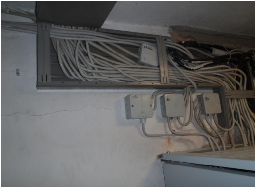
Elektrotechnik: Leitungsführungen / Brandlasten
