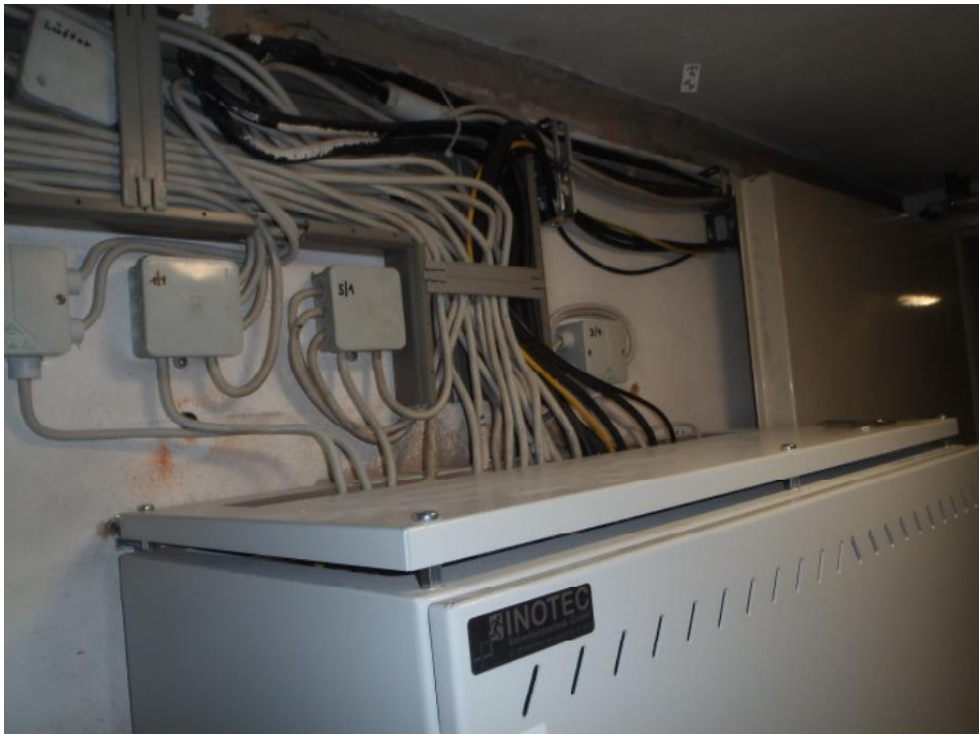
Elektrotechnik: Leitungsführungen / Brandlasten
