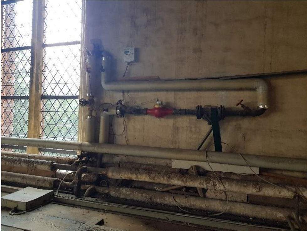
Heizung / Sanitär: Historische Wärmeverteilungsleitungen
