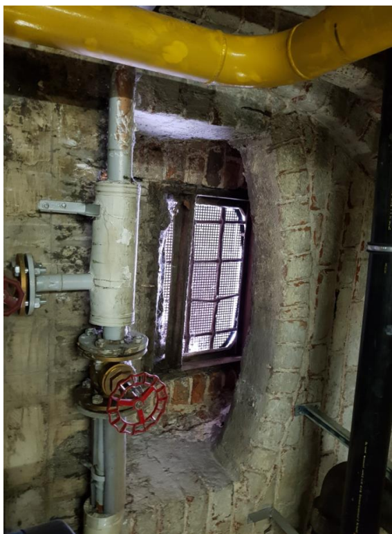
Heizung: Historische Bestandsleitungen
