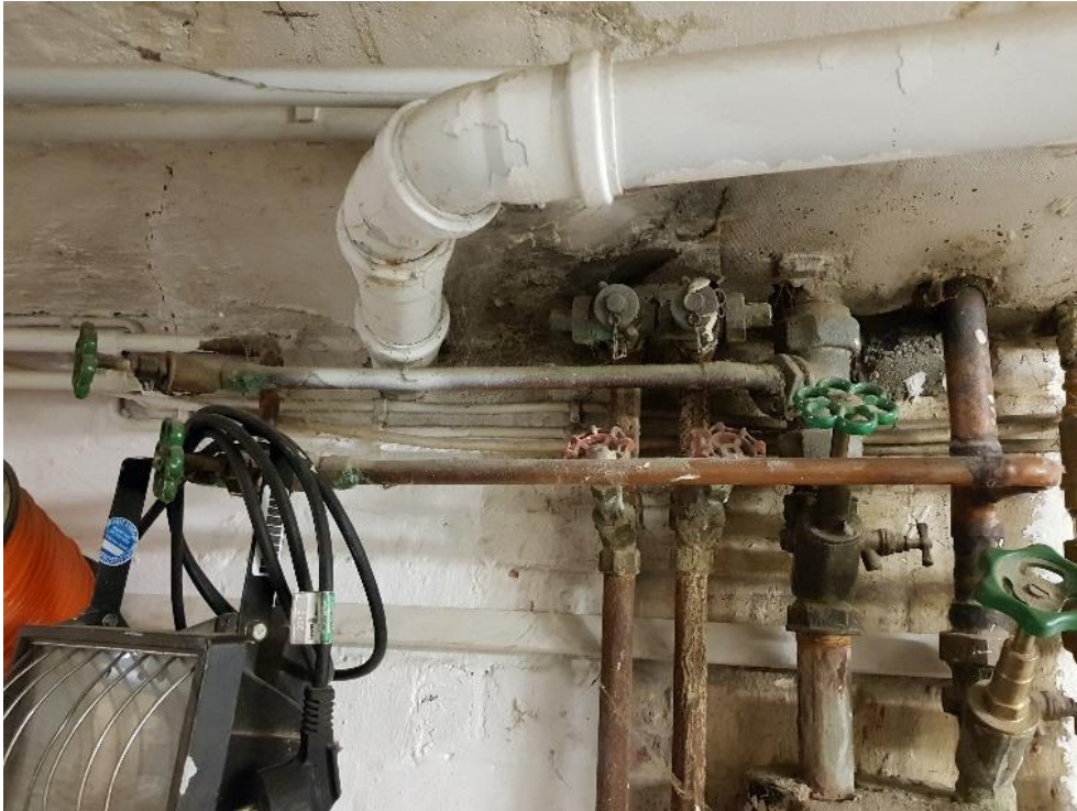
Heizung / Sanitär: Historische Abwasser- und Trinkwasserleitungen
