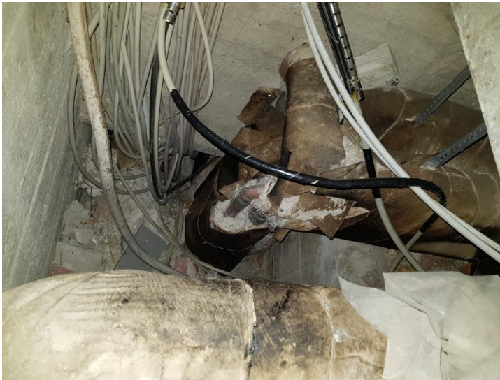
Gebäudetechnik: Installationstunnel mit unzureichender Schottung
