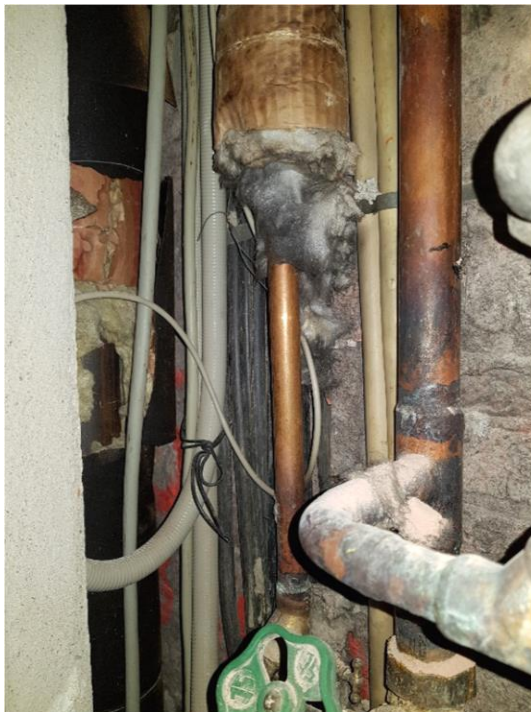
Heizung / Sanitär: Historische Bestandsleitungen (Trinkwasser und Heizung)
