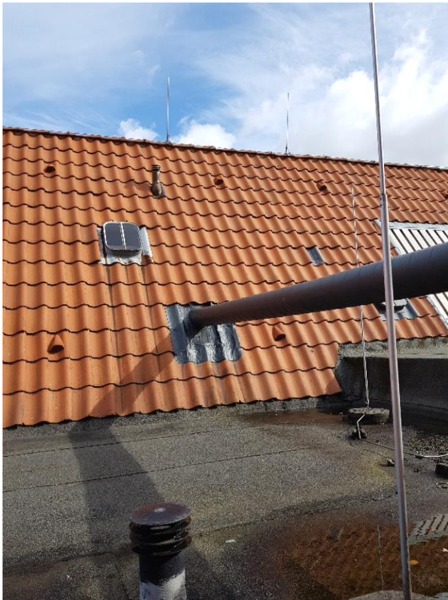
Lüftungsanlage: Lüftungskanäle im Außenbereich
