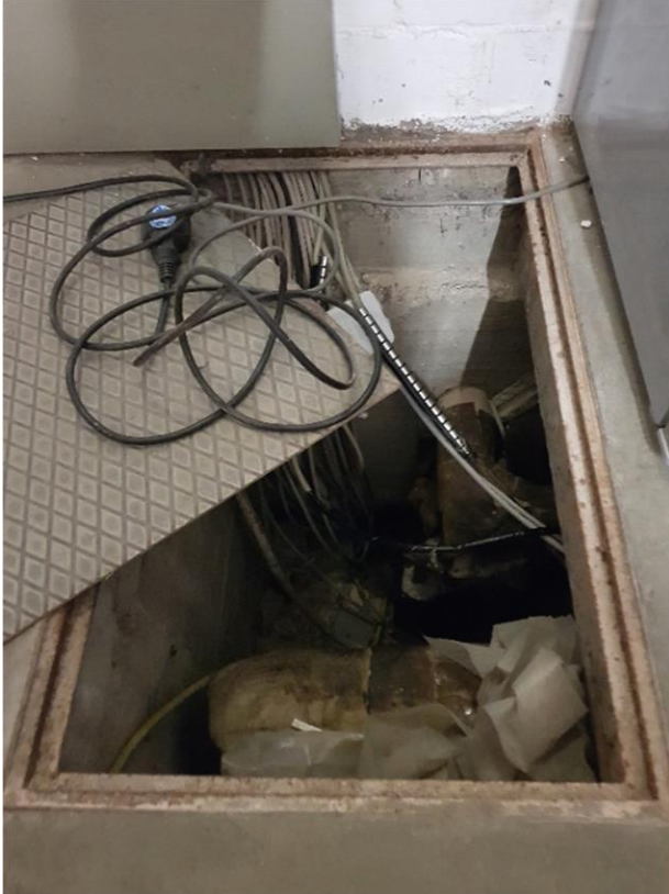
Gebäudetechnik: Installationstunnel mit unzureichender Schottung
