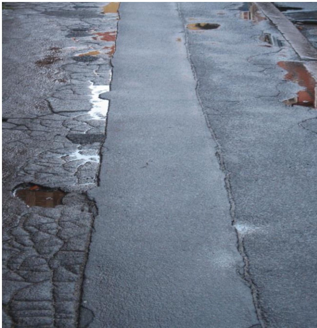
Zustand: Löcherig, Flickwerk, mehrfach geteert, Rillen, Unfallgefahr.
