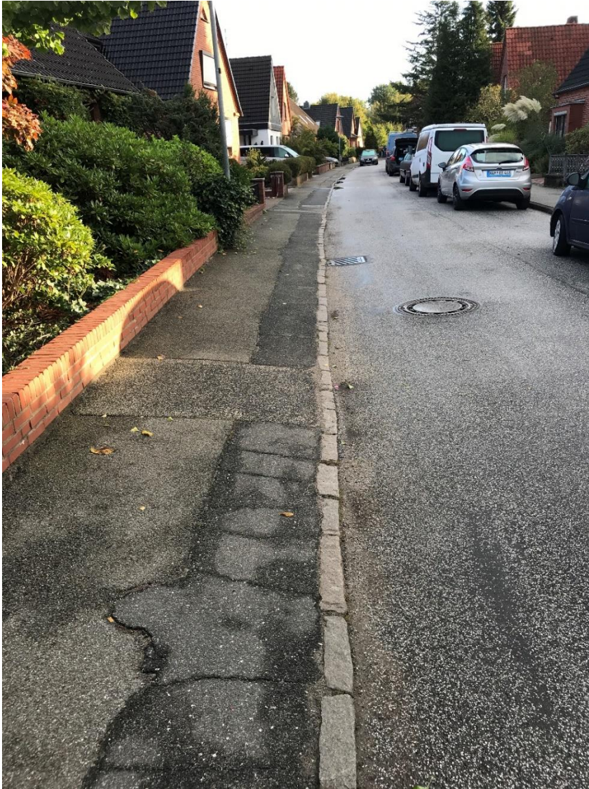
2. Foto Heidtkoppengraben, 09.10.2020, Beschwerde s.o. zw. Bildern;
