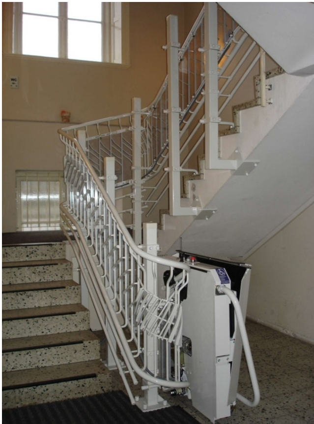
Treppenlift Villa (Bestand)
