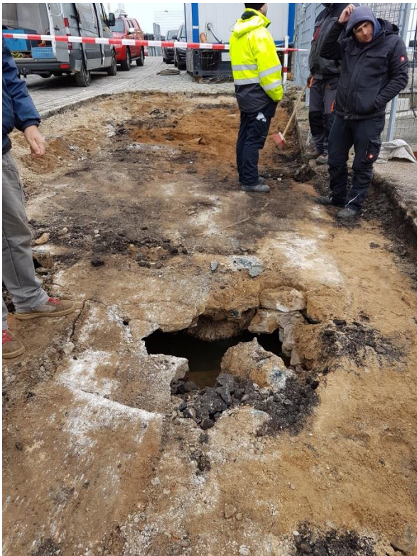
Hohlräume zwischen Straße und Kaimauer
