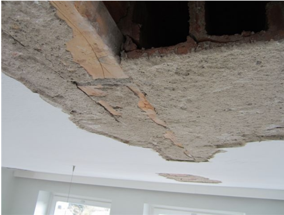
Schadstellen Decken Klassenräume
